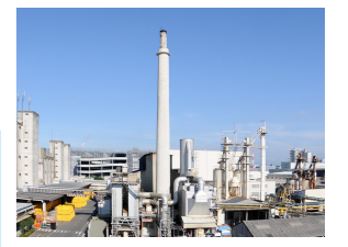
▲実証実験をした東京工場 1号炉 煙突出口の NO x 減少を確認
